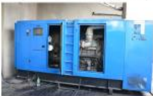
Groupe FG Wilson 400kVA (Dubai)
